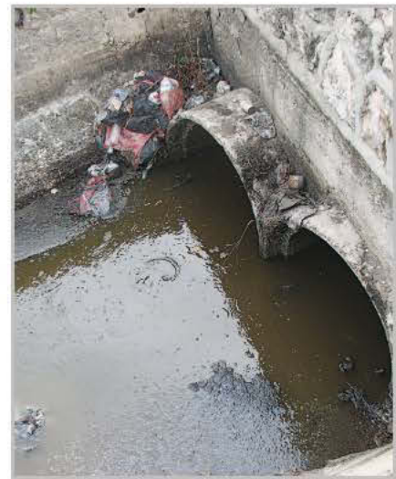
Manejo de aguas residuales
