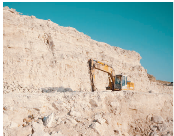
Las rocas superficiales se extraen fracturando la masa rocosa y luego se cargan mediante una retroexcavadora.
